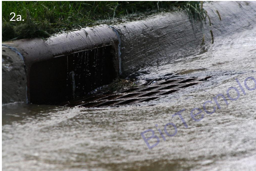
Cadoitoia a bocca di lupo per la raccolta delle acque di lavaggio delle strade o delle acque meteoriche
